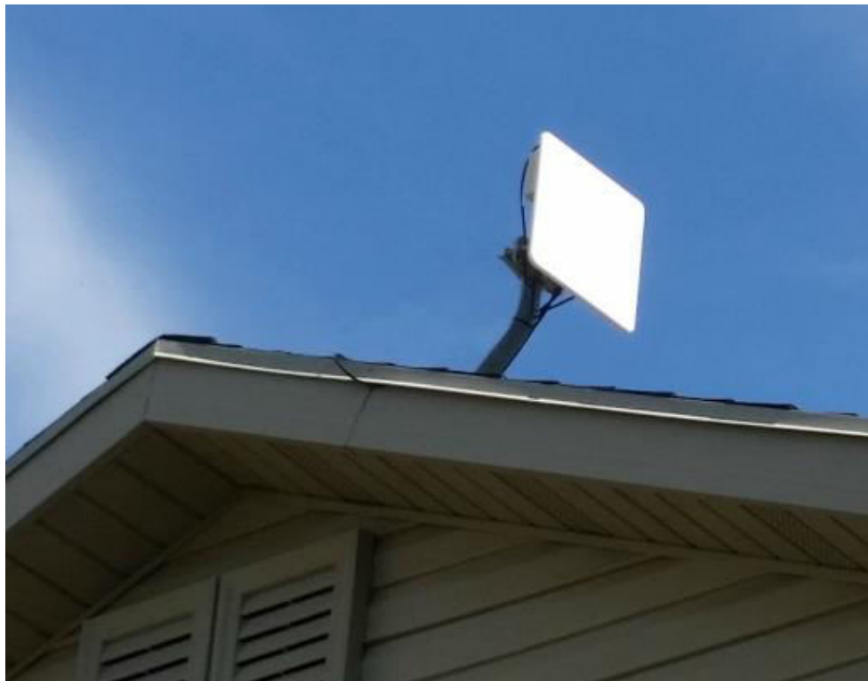
Figura 2.9.4 Antena de panel CPE instalada en el techo de un edificio de suscriptores.
