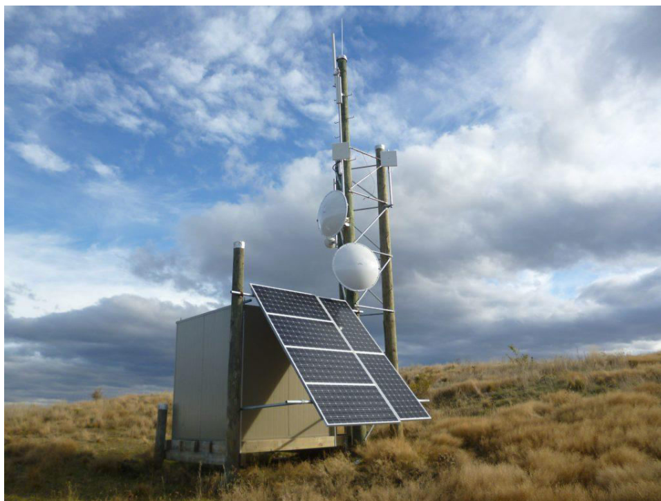
Figura 2.5.4. Antena de punto de acceso inalámbrico instalada en una ladera con vista a una ciudad.
