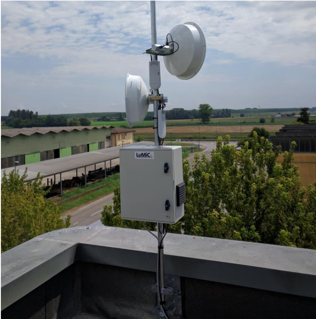
Figura 2.5.8. Antena de retransmisión/repetidor para ampliar la distancia entre la torre PtMP y el centro de operaciones de la red y para conexiones sin visibilidad directa.
