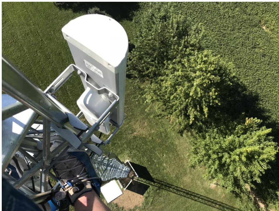
Figura 2.5.3. Antena de punto de acceso inalámbrico instalada en una torre de antena.
