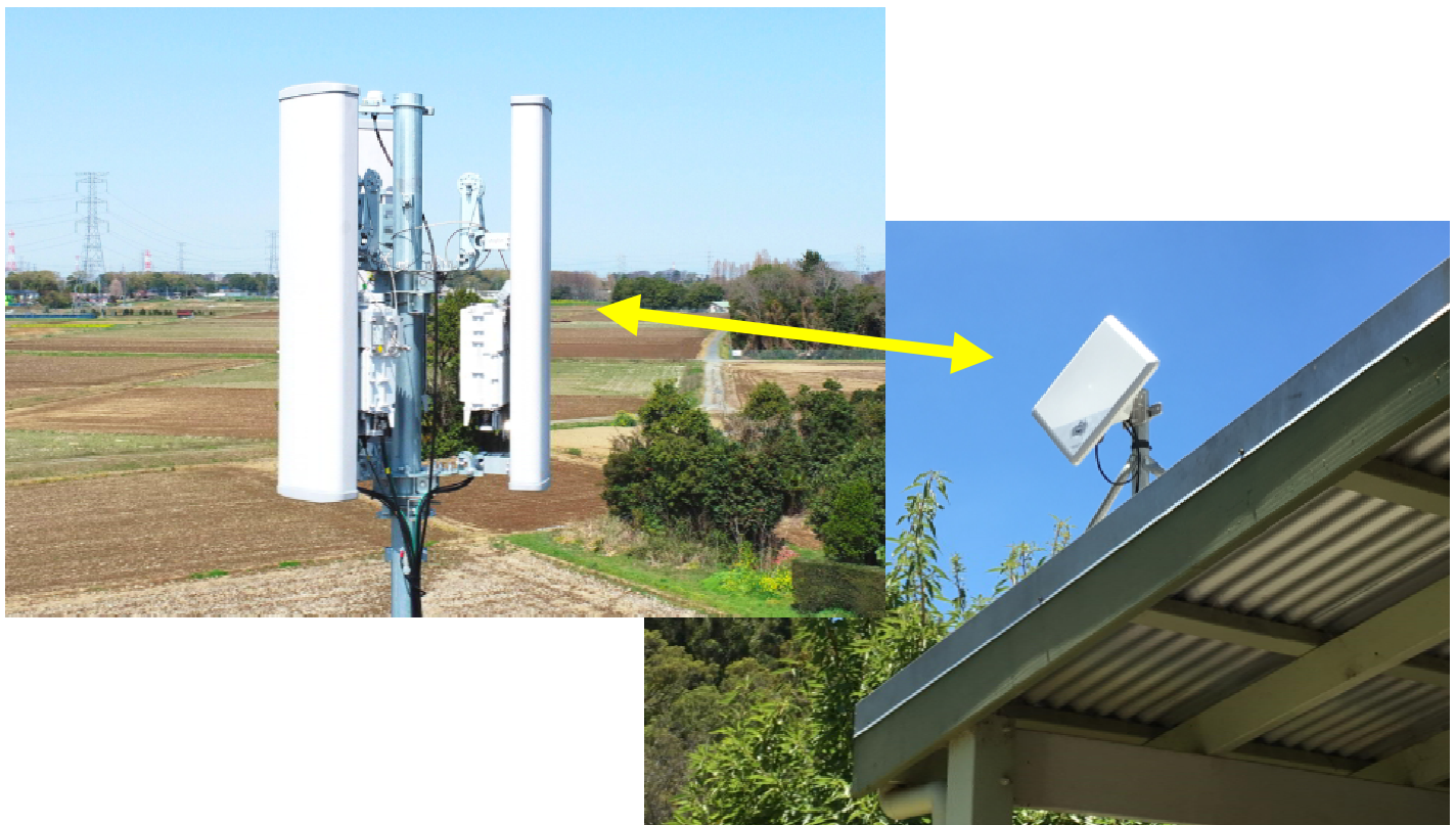
Figura 2.5.9. Antena CPE instalada en la azotea de un edificio de abonados.
