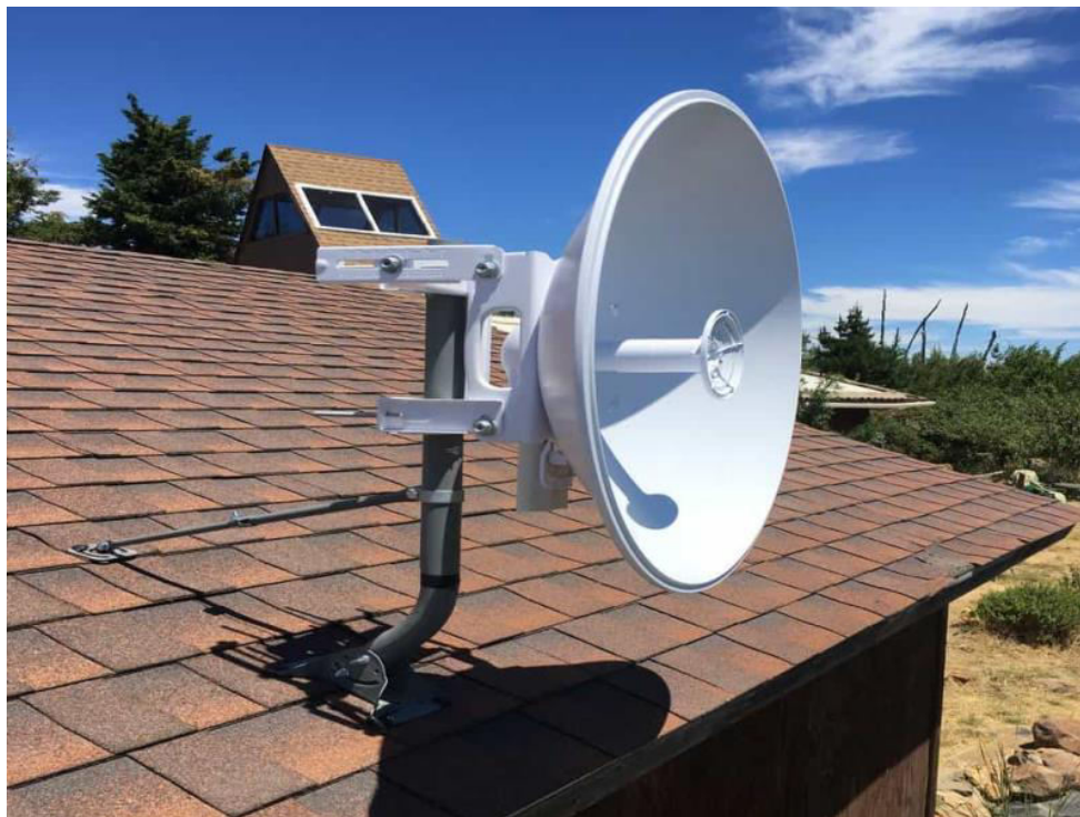
Figura 2.9.6. Antena parabólica CPE instalada en la azotea del edificio del abonado.
